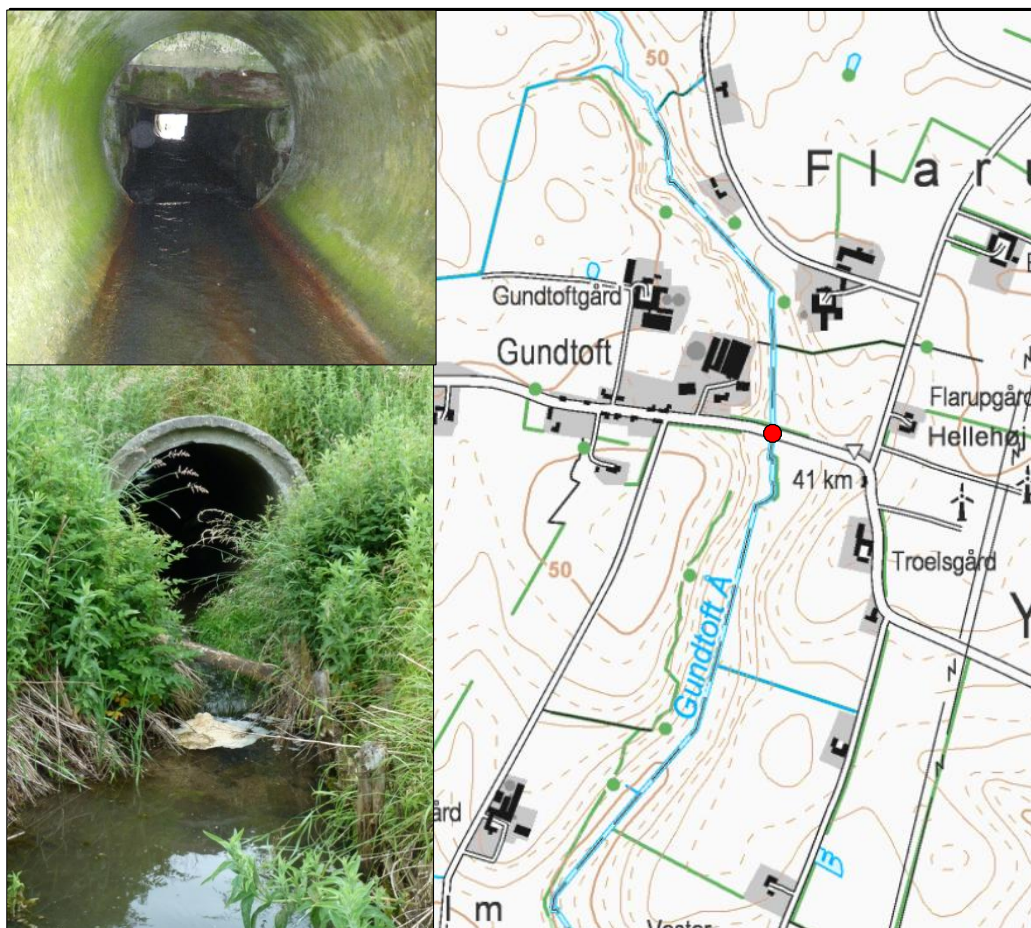
Figur 1: Spærring AAL-1189, styrt efter rørunderføring ved bro ved Gundtoft.
